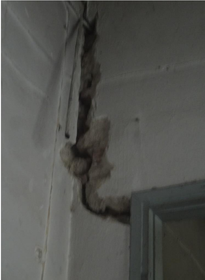
Φωτο 2 : Ρωγμή μεταξύ οπτοπλινθοδομής και λιθοδομής
